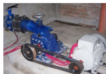
Figura 7. Válvula principal tipo mariposa cerrada.
