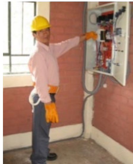
Figura 10. Manipulación del breaker a posición "ON". Fuente: Archivo fotográfico de Soluciones Prácticas,
