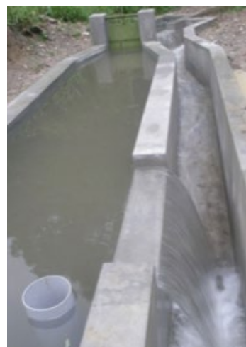
Figura 6. Cámara de carga con rebose de agua.
