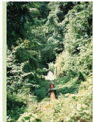
Tubería descendiendo a la casa de máquinas.
